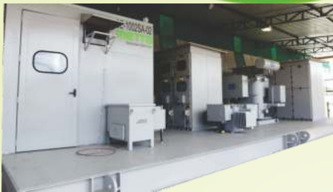
Eletrocentro de Arraste – 13x4,6m
