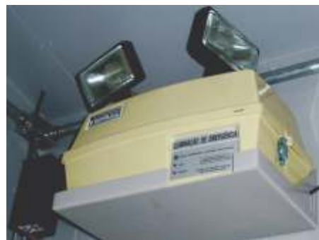
Iluminação de Emergência
