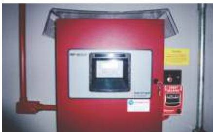
Central de Alarme Incêndio / Detectores
