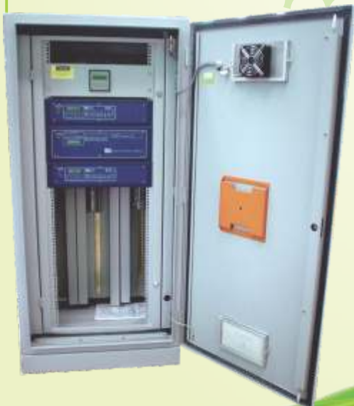
Painel de proteção de subestação "RACK 19"
