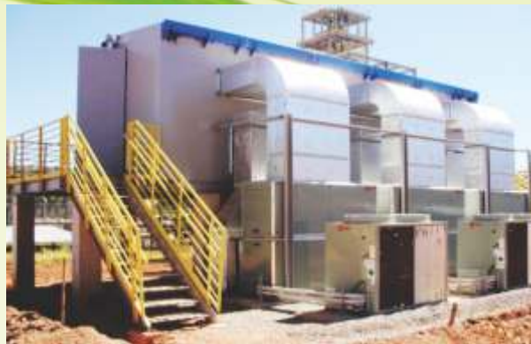
Eletrocentro – Com Climatização externa
